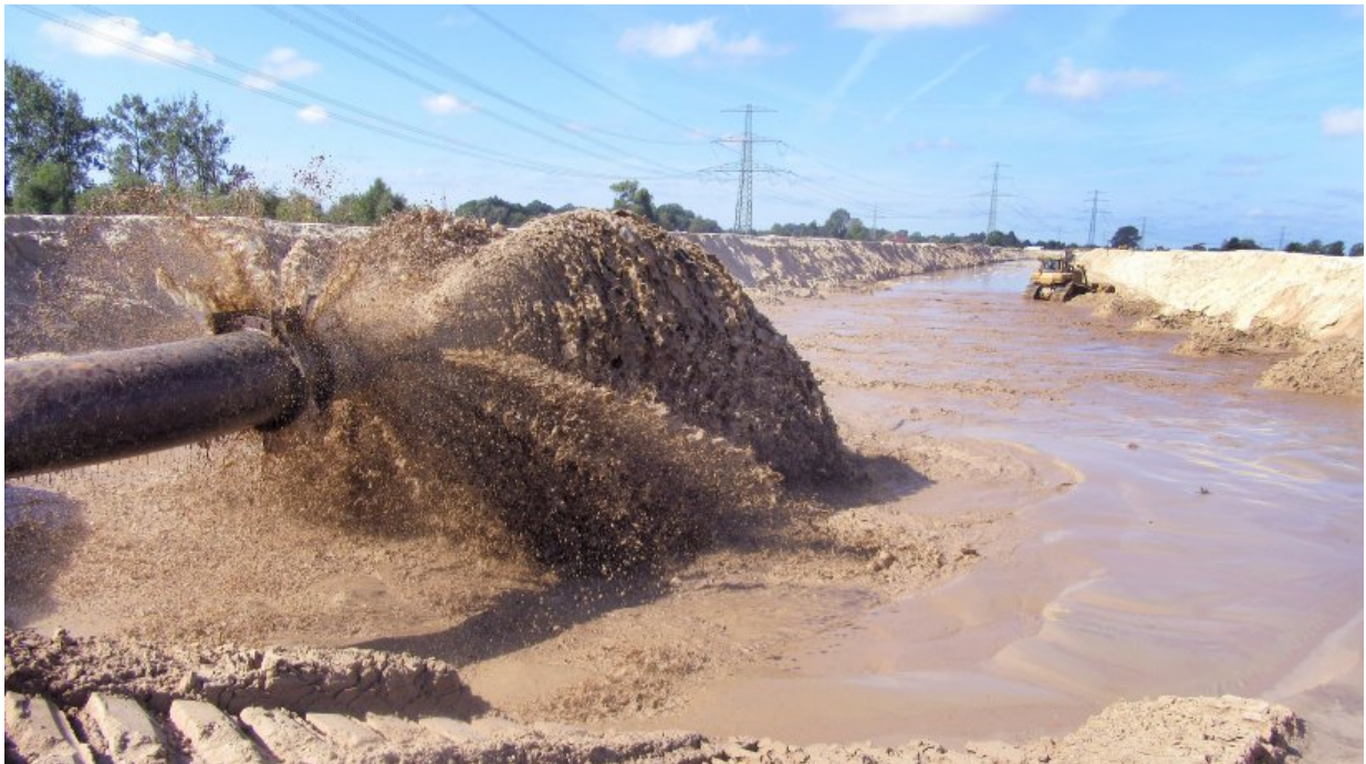
Sand wird entlang der A 26-Trasse zu großen Dämmen aufgespült, die mit ihrem Gewicht den moorigen Untergrund verdichten
