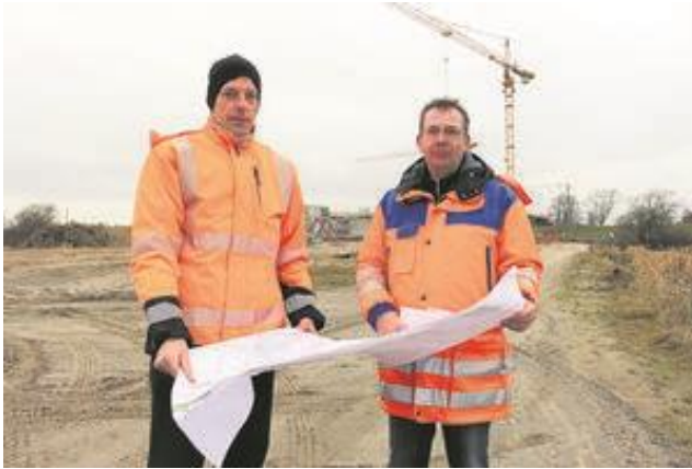
Bisher gab es keine großen Kälteeinbrüche: Projektleiter Michael Schöne (li.) und Erd- und Straßenbauspezialist Detlef Heins mit einem Plan der großen Este-Brücke
